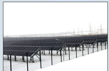
Солнечные батареи установленные на сваях производства ЮУЗВС «Егоза». Орская солнечная электростанция имени А. А. Влазнева
